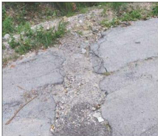
Le condizioni in cui è stata lasciata la strada di via Consolini
